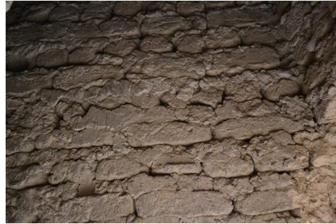
Fig. 23: Tour-minaret, parois intérieure, détail de la maçonnerie en brique crue
